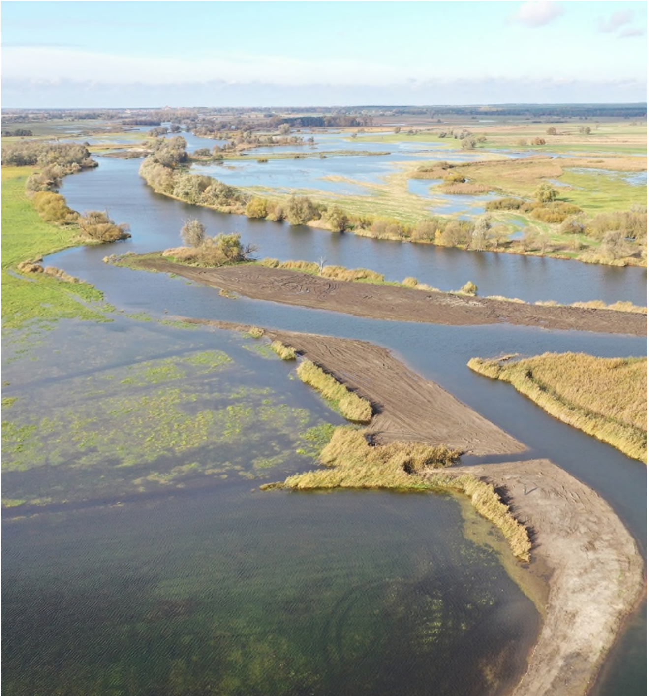
Abb. 1: Altarmanschluss "Breite Dunau" nach Fertigstellung an der unteren Havel. Quelle: NABU IFA, Rocco Buchta
