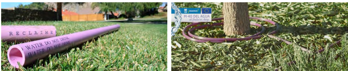
Abbildung 86: Beispiele für Verteilungssystemen für die Bewässerung urbaner Grünflächen mit aufbereitetem Wasser, links mit Warnhinweis auf dem Rohr, rechts separate Warnung (McCann et al., 2018; Madrid, 2023)
